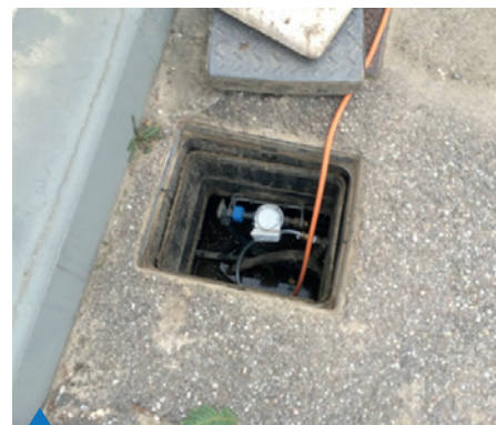
Passage de la sonde de traçage par le compteur d'eau
