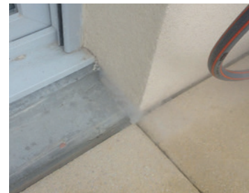
Apparition de fumée au niveau des menuiseries extérieures.
